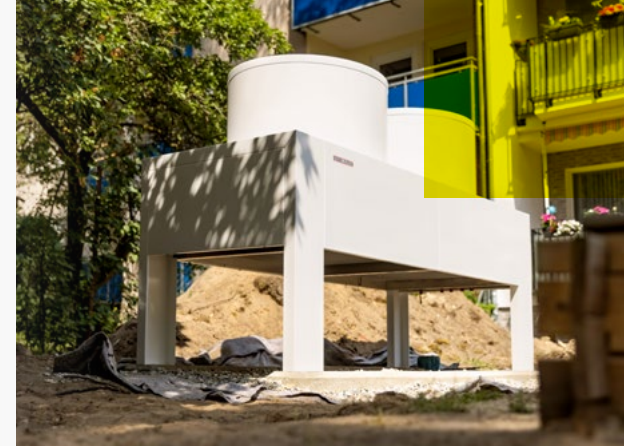
Diese Luft-Wasser-Wärmepumpe in Hannover-Vahrenwald hat eine alte Gasetagenheizung ersetzt.
